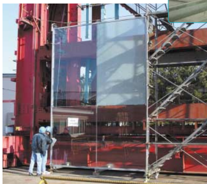
モックアップによる実験の様子。防火ガラス部分の上下2段を再現。右上の面ガラスを割った実験でもシール材によって支えられ、ヒビが入っただけで破片は落下しなかった
